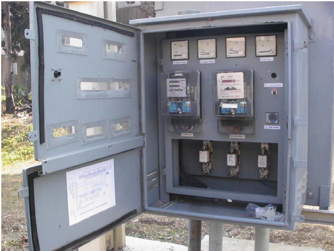
Gambar 2.16 Kwh meter tiga fasa dan KVARh
