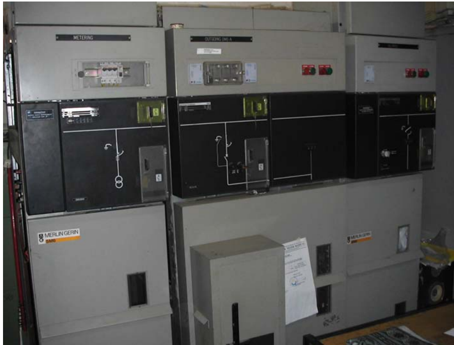
Gambar 2.20 Contoh cubicle di ruang praktek POLBAN
